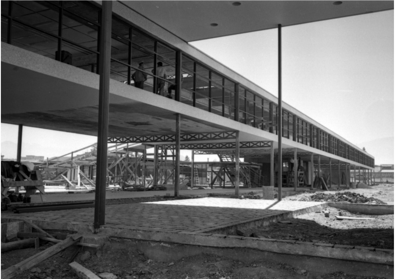
Edificio de Logias, en construcción. Fuente: Archivo de Documentación Gráfica y Audiovisual de la Universidad de Santiago de Chile.
