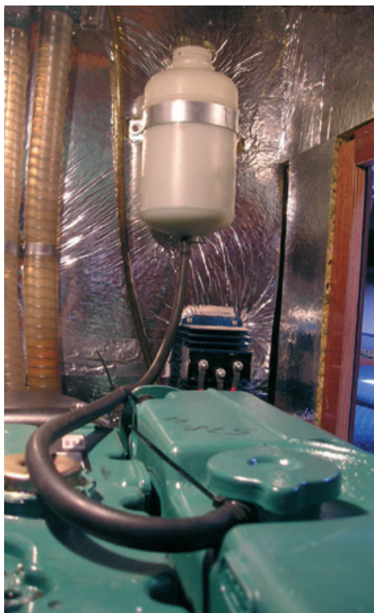
Fig. 4. Tanque de expansión
