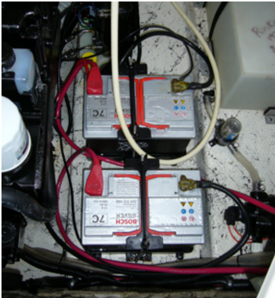
Fig. 9. Batería sin mantenimiento
