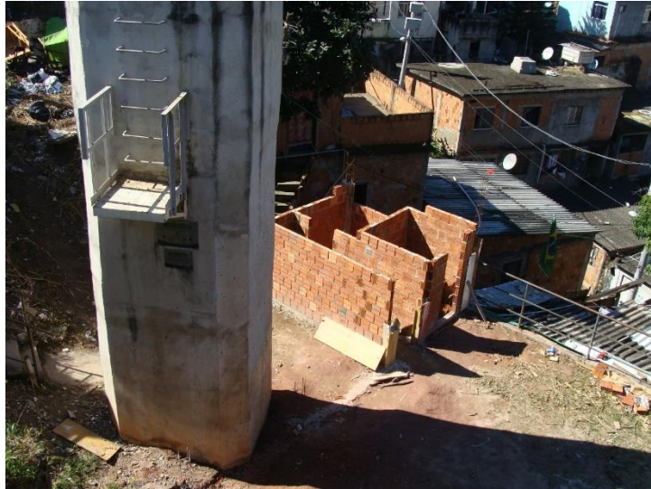
Fig. 11. Casa en construcción en una área no edificable.
