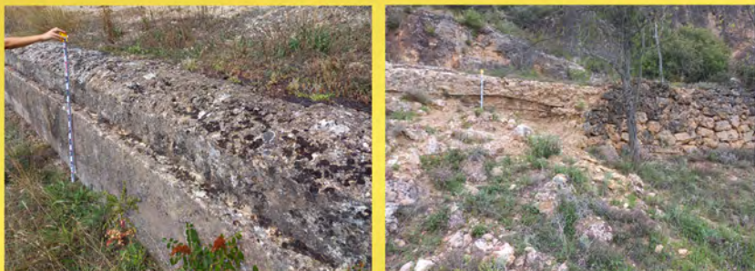
Conducción en fábrica de hormigón y Canal, con derrumbe del muro soporte y cimentación del canal
