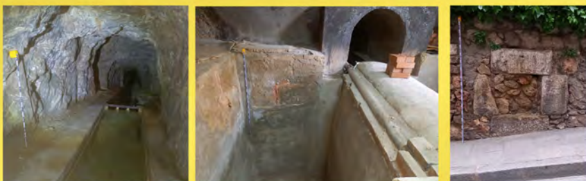
Galería de la conducción, bajo el Puente del Castillo. Vaso del filtro y entrada. Arca para válvula de descarga.
