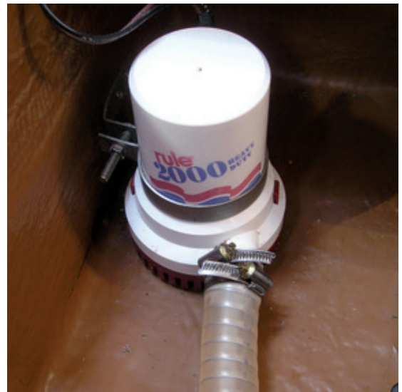
Fig. 19. Bomba de achique
