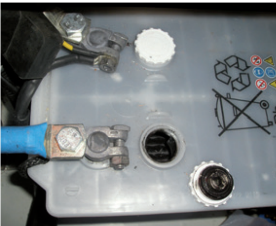
Fig. 43. Entrada para el relleno de la celda de la batería
