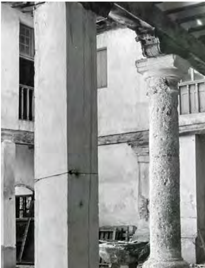
Rincón del claustro antes de la restauración
