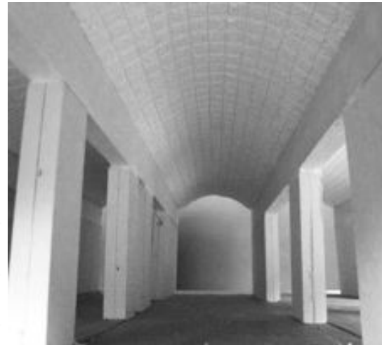
S'introdueix una capa sobre les voltes per evitar que s'obrin (amb els materials restants de la construcció), en aquest espai es permet un constant corrent d'aire que manté l'interior refrigerat
