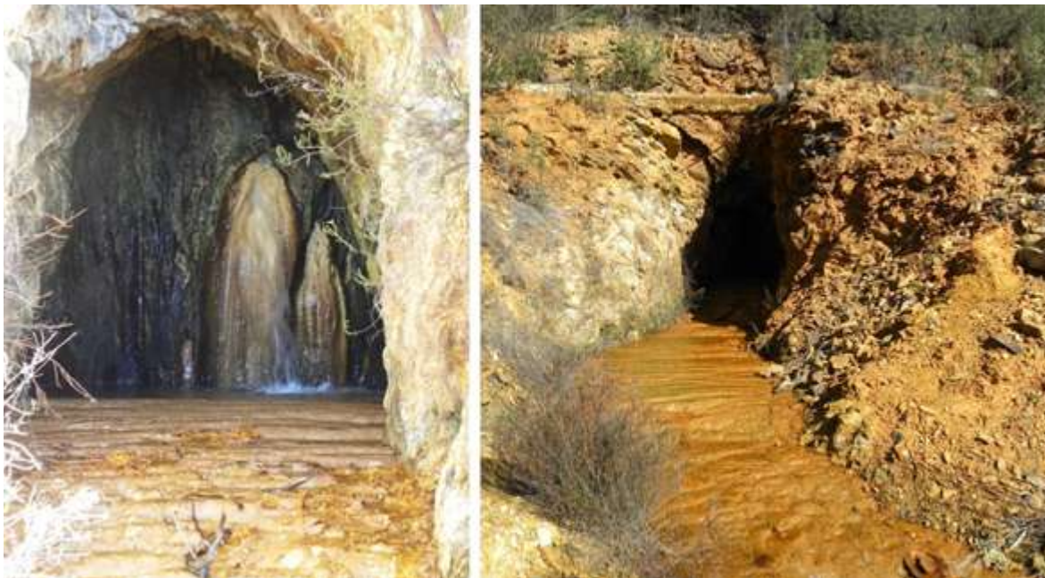
Figura 7.7: Fotografía del tapón de hormigón de la galería en Tinto Santa Rosa mostrando la fuga a presión de aguas ácidas. General (derecha) y detalle (izquierda).
