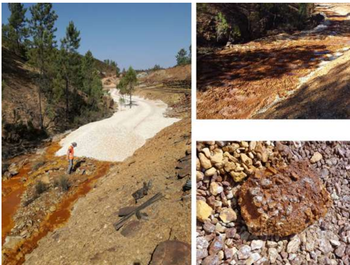
Figura 7.18: Construcción de un canal calizo abierto (OLC) tras el vertido accidental por la rotura del sello de la galería de Los Cepos en la mina de la Zarza (junio de 2017). Esta medida resultó ineficaz debido a la encapsulación de la caliza por la intensa precipitación de hierro, en la parte derecha se muestra el canal pasivado y detalle de un bloque mostrando la intensa precipitación de hierro rodeando totalmente a los granos de caliza.
