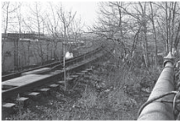
Figura 2. Estado de abandono de la línea férrea.
