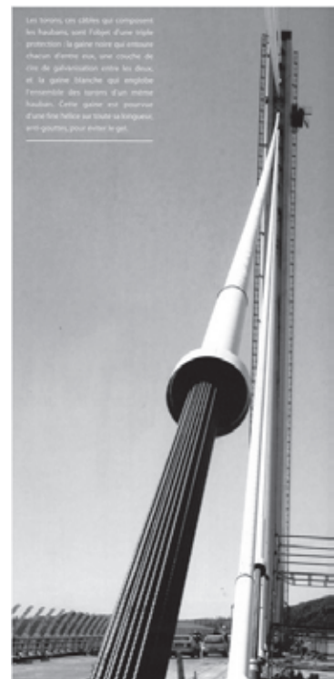
Figura 43. Cableado de tracción y vaina.
