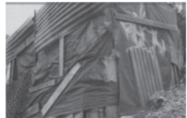
Figura 16. Estanqueidad de cerramientos laterales.
