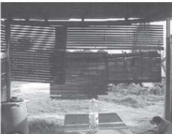
Figura 13. Deformación de viga soporte cubierta.
