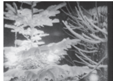
Figura 22. Escarcha desde el interior del baño.
