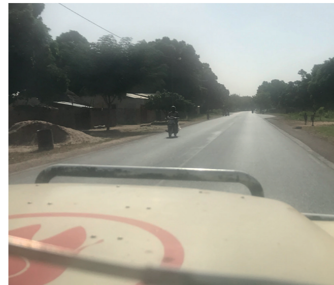
Pavimento asfáltico en la salida de Kaolack. Fuente propia.
