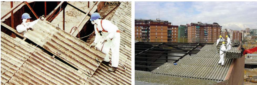
Fig. 54.2. Ejemplos del proceso de sustitución de las placas de fibrocemento con amianto existentes.
