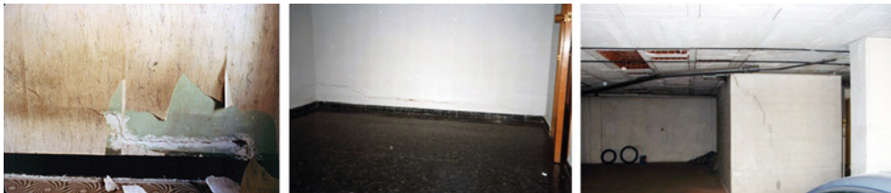
Fig. 19.2. Ejemplos de rotura de tabiquerías originadas por la flexión del forjado y la consiguiente pérdida de apoyo de su parte central.
