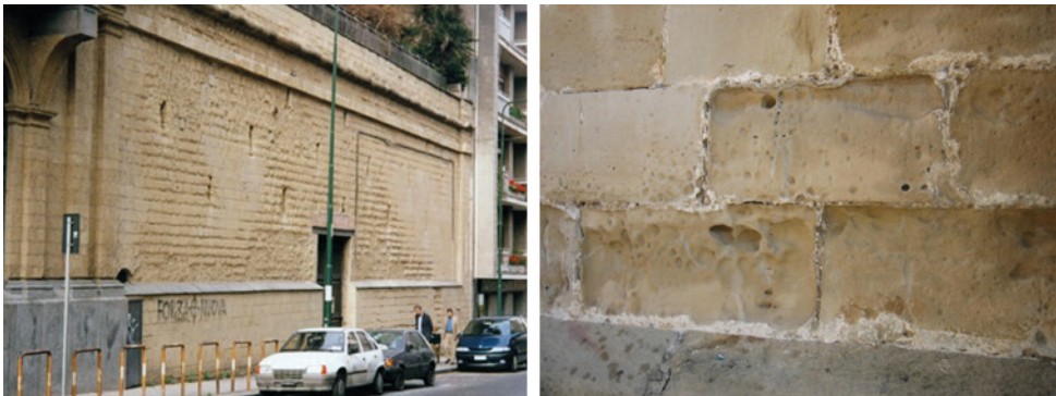
Fig. 50.1. En la foto de la izquierda, erosión de un muro de piedra eruptiva (tufo) afectada por el agua de lluvia. En la foto de la derecha, muro con erosión en su base, más avanzada en los mampuestos que en las juntas de mortero, las cuales muestran eflorescencias.
