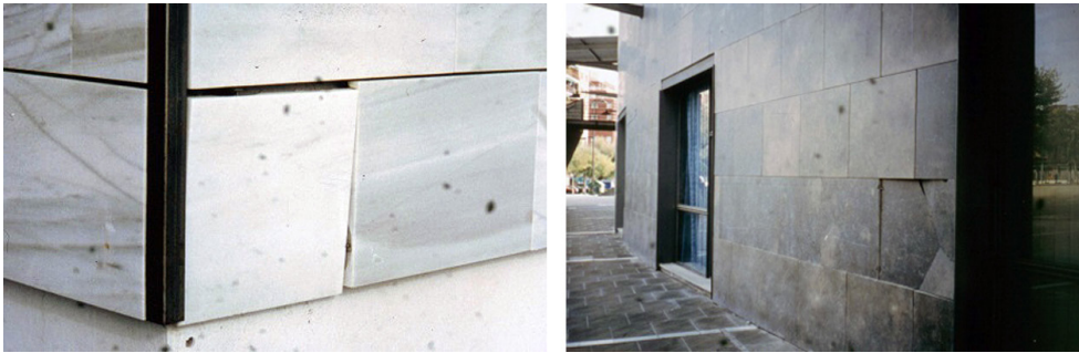
Fig. 40.5. Movimiento de una pieza con insuficiencia de anclajes y rotura por impacto de una pieza de escaso grosor.
