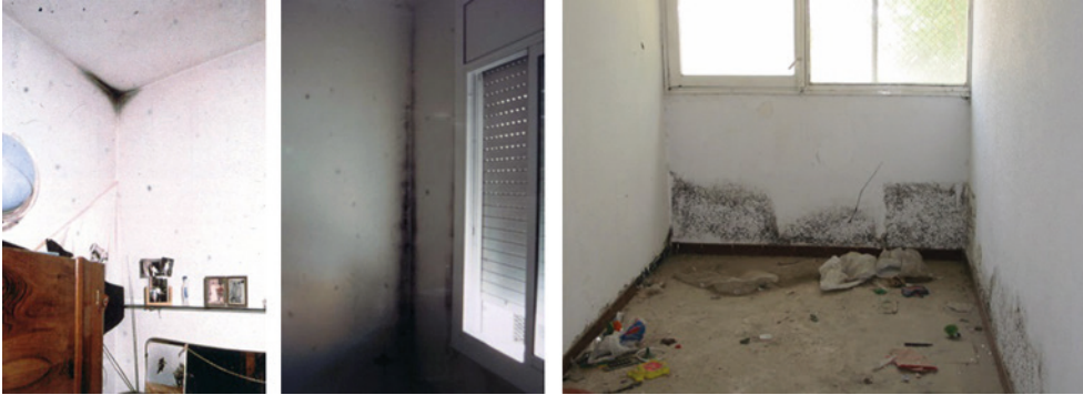
Fig. 44.1. Ejemplos de formación de moho en localizaciones con escasa ventilación, en rincones de los paramentos y detrás de los muebles adosados.
