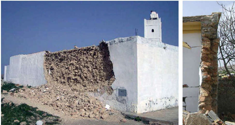
Fig. 31.3. Ejemplo de un tramo de muro colapsado por movimiento sísmico.
