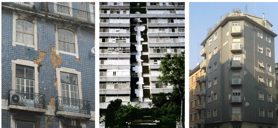
Fig. 39.1. En la foto izquierda, desprendimientos de losetas acaecidos a lo largo de los años sujetas con mortero de cal a un muro grueso. En la foto central, zonas con losetas desadheridas tomadas con mortero cola después de su revisión sistemática por golpeo superficial. En la foto derecha, plaquetas desadheridas con la misma problemática.
