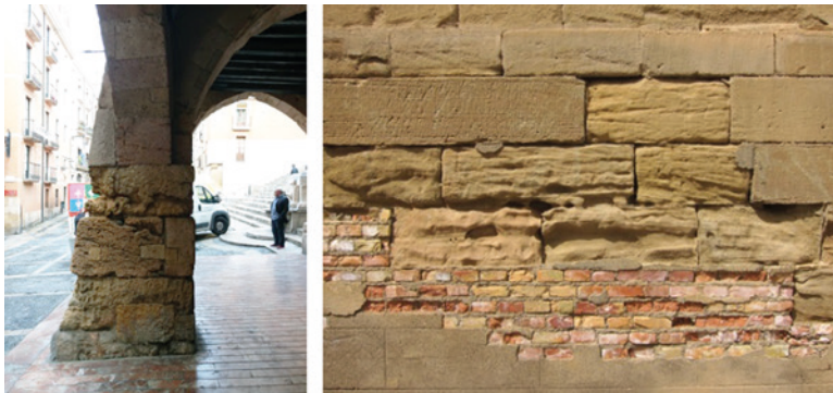
Fig. 50.2. En la foto de la izquierda, erosión de un pilar de piedra con incrustaciones puntuales de refuerzo. En la foto de la derecha, muro con erosión avanzada en algunos mampuestos junto a tramos de muro ya reconstruidos con ladrillo.
