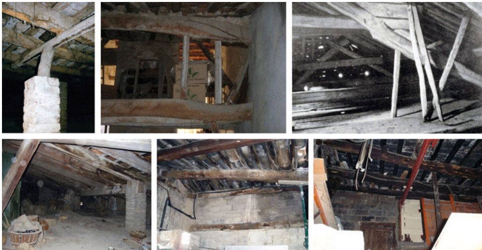
Fig. 55.1. Ejemplos de desvanes con actuaciones improcedentes o en estado avanzado de deterioro de los elementos estructurales de soporte de la cubierta.
