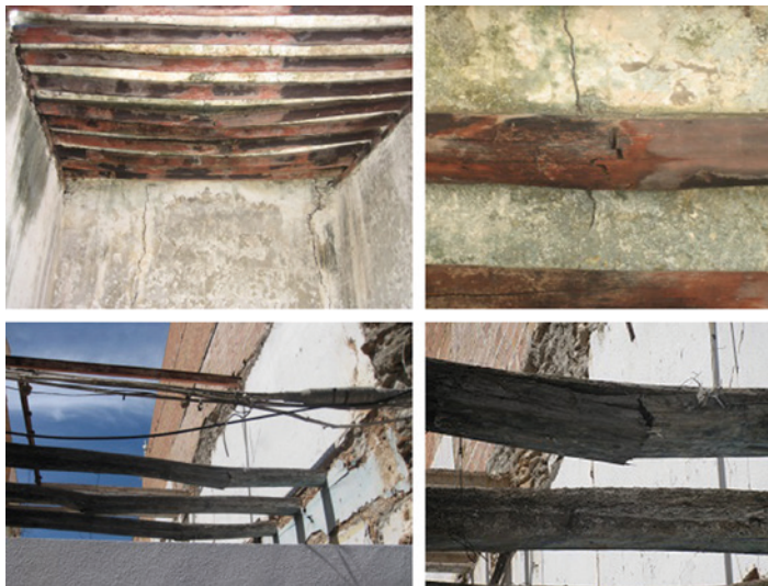
Fig. 18.1. Fractura por la parte inferior y central de algunas de las viguetas de un forjado, en la zona que experimentó mayores tensiones de tracción.
