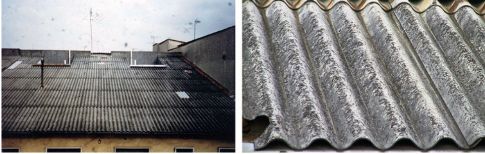
Fig. 54.1. Aspecto de placas de fibrocemento con amianto envejecidas, con posible superación del nivel de friabilidad permitido al amianto.
