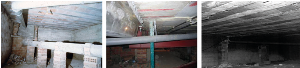
Fig. 35.2. Ejemplos del interior de algunas cámaras sanitarias. Se observa la presencia de conductos de evacuación y, en la foto de la derecha, los nervios de hormigón armado del forjado con síntomas de alteración.
