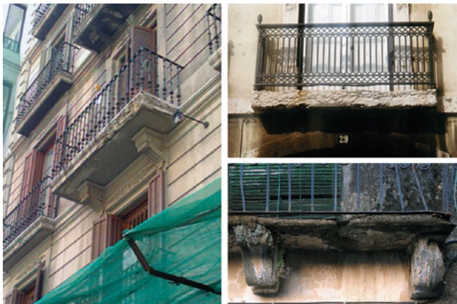
Fig. 27.1. Losas de balcón de piedra natural con diversas formas de alteración del material.
