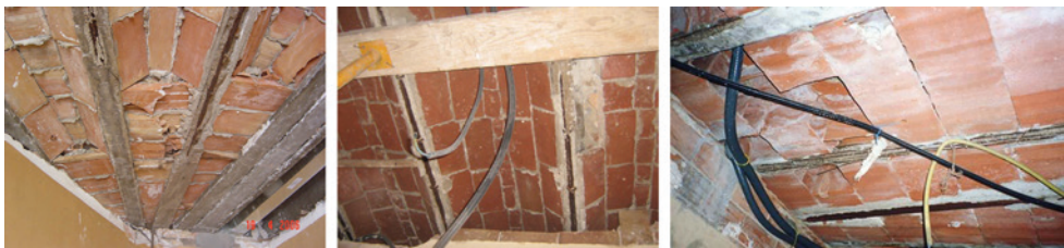
Fig. 21.2. Viguetas con contenido de cemento aluminoso y con claros síntomas de corrosión de sus armaduras iniciados a los pocos años de su puesta en obra.
