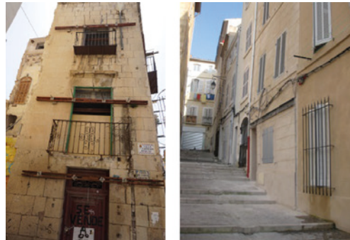
Fig. 2.5. Ejemplos de disposición de perfil metálico a modo de anclaje conjunto de los atirantamientos transversales. En el edificio de la foto de la izquierda, la solución se plantea como medida provisional preventiva; en el de la derecha, como solución definitiva.
