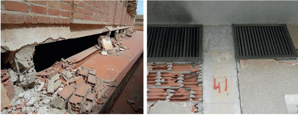
Fig. 31.5. Pilar corto y pilar con el movimiento impedido por los entrepaños de obra con roturas a cortante por efecto del sismo.
