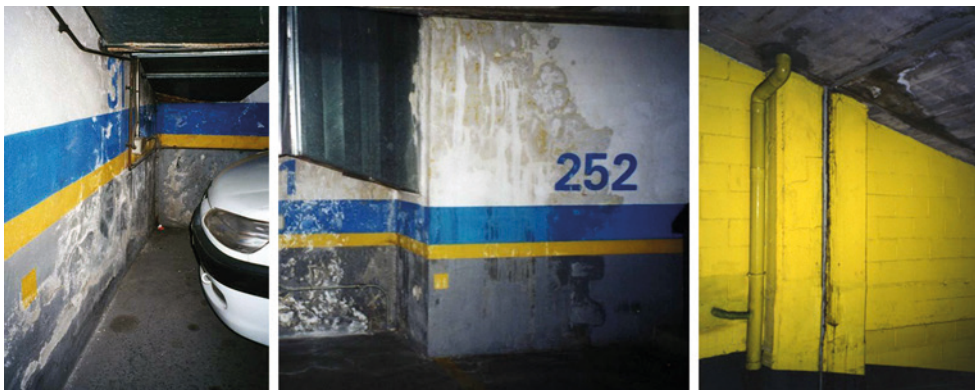
Fig. 34.1. Humedades en los muros de contención de hormigón armado de un sótano destinado a aparcamiento de vehículos. En la foto central se distingue claramente la coincidencia de una de las manchas con una fisura y en la de la derecha con la entrega superior del muro con el forjado.
