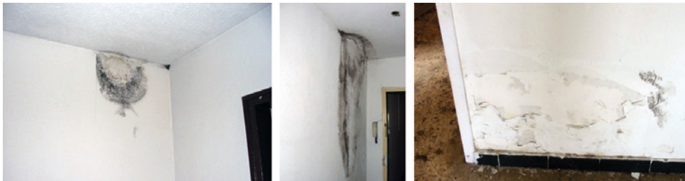
Fig. 59.1. Ejemplo de manchas de humedad con presencia de moho, formadas por el agua que transcurre por los conductos de las instalaciones.
