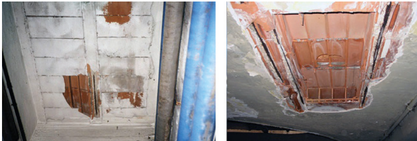
Fig. 23.2. Ejemplos de casetones rotos a causa de la corrosión de las armaduras en los elementos de apoyo.
