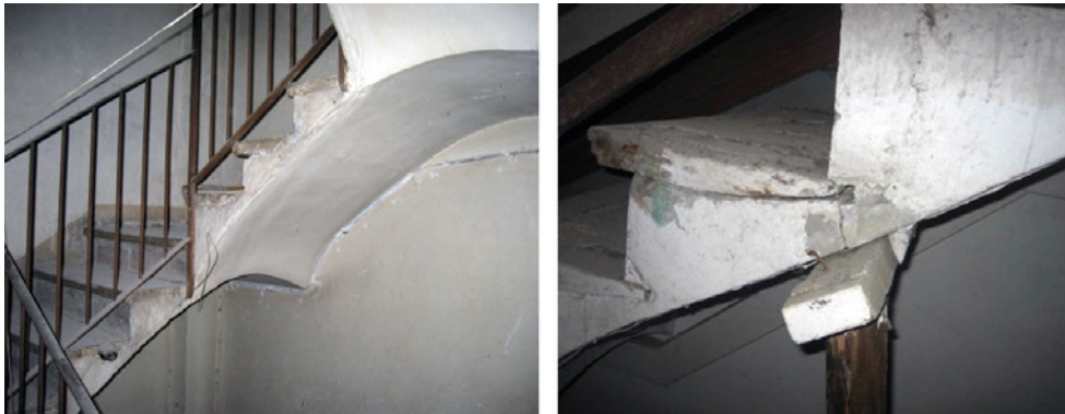
Fig. 26.1. En las fotos de la izquierda, desarrollo de las bóvedas en los muros de las cajas de escaleras. En la foto de la derecha, bóveda fisurada transversalmente convenientemente apuntalada.
