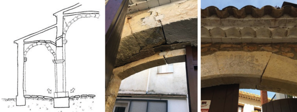
Fig. 25.7. En el gráfico, desperfectos originados en las bóvedas por el asiento y giro de un pilar. En las fotos, arco exento de un portón de entrada con grieta cercana a su clave originada por el movimiento diferencial de sus bases de apoyo.
