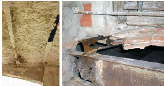
Fig. 24.1. En la foto de la izquierda, viguetas metálicas con el ala inferior fuertemente corroída, en contacto con entrevigado de mortero de cal. En la foto de la derecha, alma de una vigüeta metálica completamente corroída en un forjado formado por revoltones de rasillas de dos capas de grosor en una galería exterior de un edificio de viviendas.
