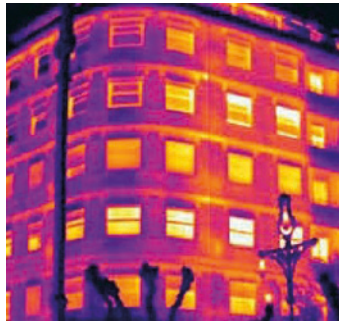
Fig. 61.2. Imagen termográfica que muestra, en amarillo, los puentes térmicos y las zonas con mayores pérdidas de calor del interior.
