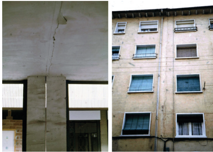
Fig. 32.1. En la foto de la izquierda, grieta en el revestimiento del forjado coincidente con el recorrido de la junta de dilatación del edificio. En la foto de la derecha, grieta vertical en el revestimiento que recubre la junta entre dos fases de ejecución del edificio.
