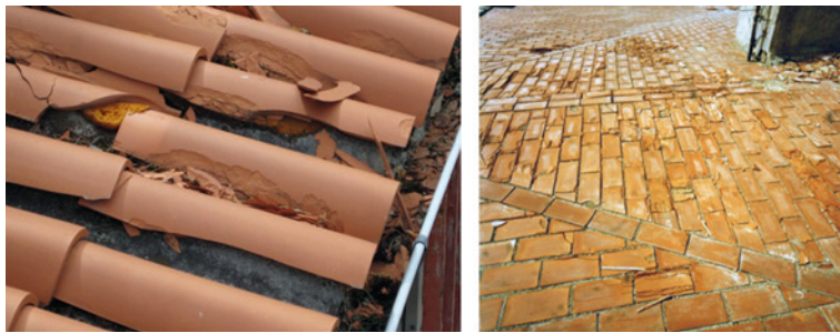
Fig. 56.2. Cubierta de teja árabe y pavimento cerámico de cubierta afectados por el efecto del hielo.
