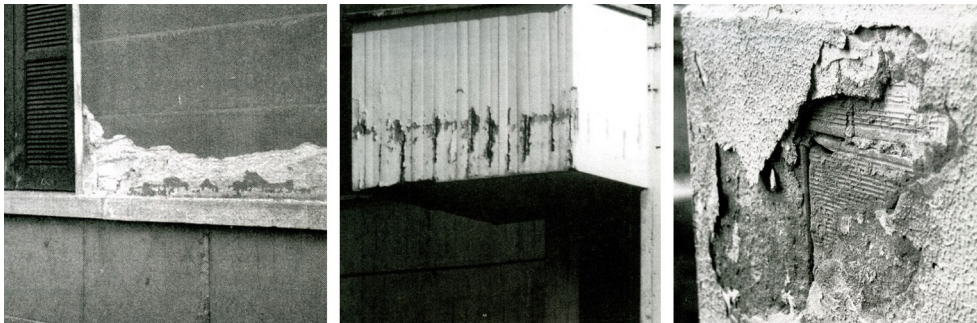
Fig. 48.1. En la foto de la izquierda, la acumulación de agua sobre la moldura de piedra origina la humectación del revoco de la fachada. En la foto central, filtración a través de la barandilla en su contacto con la losa del balcón. En el gráfico de la derecha, el desconchado del revoco se forma justo encima de la junta entre un pilar y la cerámica del cerramiento de obra.
