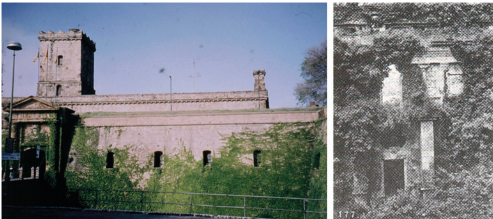
Fig. 57.1. Dos ejemplos de muros con presencia de plantas trepadoras con factible efecto sobre las juntas mortero o de las piedras de la mampostería.
