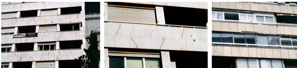
Fig. 40.6. En las fotos izquierda y central, fachada recubierta con piezas de piedra con presencia de vetas ferruginosas. En la foto de la derecha, afectación de la parte inferior de las piezas de un recubrimiento de piedra artificial debido a la retención del agua de lluvia infiltrada en esta parte.
