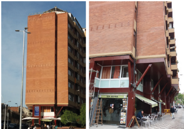
Fig. 19.5. Refuerzo con perfilería metálica de los tramos en voladizo del primer forjado que soportan las cargas transmitidas a través de las fachadas.
