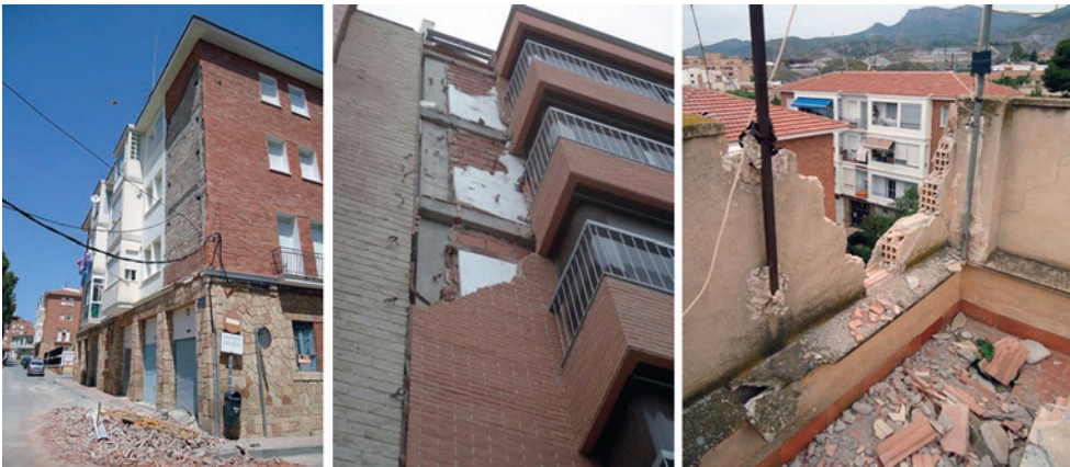
Fig. 31.6. Ejemplos de paramentos y barandillas de las fachadas desprendidas hacia la calle por el efecto del sismo.
