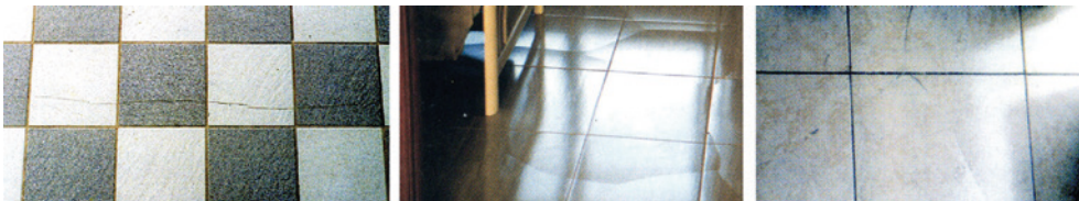
Fig. 58.3. En la foto de la izquierda, grieta formada en solado sobre capa excesivamente compresible. En las fotos central y derecha, grietas siguiendo recorridos de grietas de retracción en las soleras.
