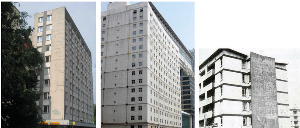
Fig. 42.1. Ejemplos de fachadas afectadas por el efecto del choque térmico.
