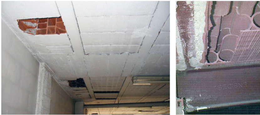
Fig. 23.1. Ejemplos de casetones rotos coincidiendo con tramos en que los apoyos difieren en el movimiento de flexión del forjado.
