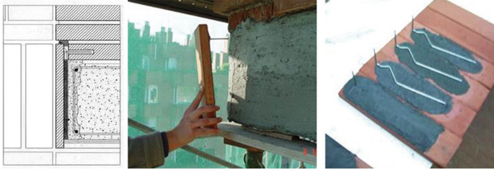
Fig. 41.6. Ejemplo de refijación de piezas cerámicas mediante clavado de varillas de acero inoxidable a la primera hilada de ladrillo por encima del forjado.
