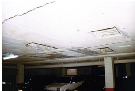
Fig. 23.3. Ejemplos de casetones de yeso rotos coincidiendo con tramos de paso del coche-grúa de retirada de vehículos de la vía pública.
