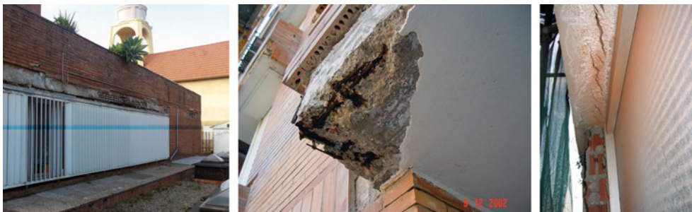
Fig. 41.3. Efectos de la corrosión de las armaduras del hormigón del forjado sobre los recubrimientos. En la foto de la derecha, las fisuras en el mortero de agarre de un tramo de recubrimiento cerámico muestran los efectos de la dilatación térmica que ha experimentado.
