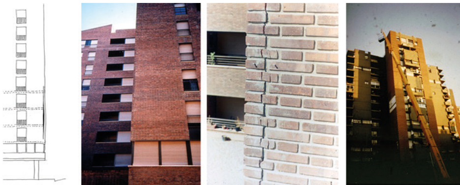
Fig. 36.1. En las tres fotos de la izquierda, edificio de 10 plantas con fisuras en el tercio inferior de las esquinas salientes. En la foto de la derecha, colapso de un tramo intermedio de una fachada de un edificio de 19 plantas. En ambos edificios el apoyo de los muros en los forjados era escaso.
