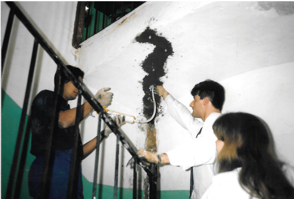
Fig. 26.2. Puesta en obra de un procedimiento de inyección en una bóveda cerámica rota por un movimiento general del edificio.
