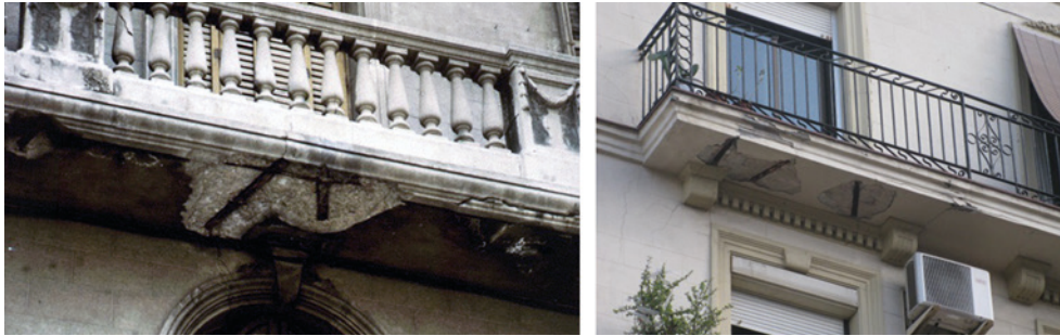
Fig. 24.2. Ejemplo de dos balcones soportados por viguetas metálicas con el revestimiento inferior desprendido por los efectos de la corrosión de los perfiles.
