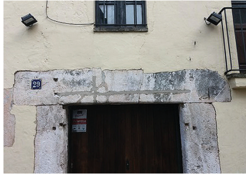
Fig. 12.3. Dintel formado con tres dovelas de piedra tallada reforzado con armadura de acero empotrada.
