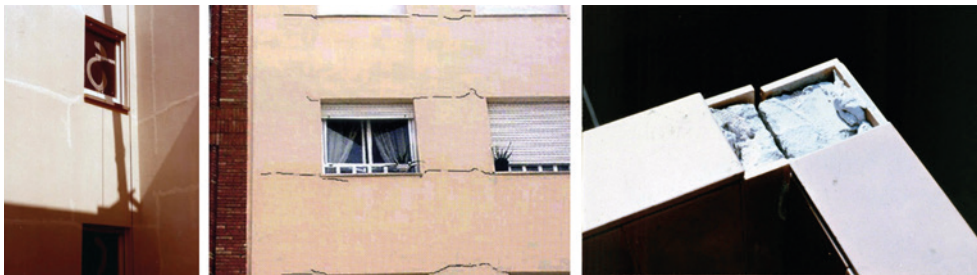
Fig. 38.3. En las fotos de la izquierda y del centro, fisuración por retracción coincidiendo con juntas frías de la puesta en obra de los muros. En la foto de la derecha, situación inestable de una barandilla de hormigón ligero con grieta de retracción en uno de sus extremos.
