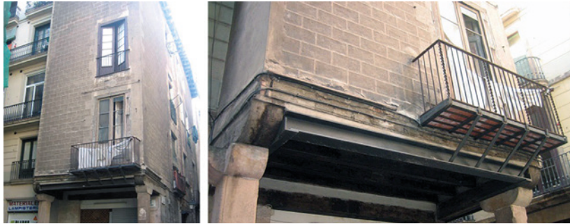
Fig. 24.6. Singular intervención de restitución de la losa con piezas cerámicas y sustitución parcial de los perfiles existentes reforzándolos con tornapuntas metálicos apoyados en nueva viga cargadera dispuesta en la fachada.
