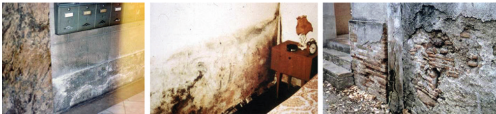
Fig. 33.2. Eflorescencias salinas aureolando las manchas de humedad ascensional. En la foto de la izquierda, vestíbulo de edificio urbano con manchas producidas por la rotura del albañal. En la foto del centro, formación de moho en un muro húmedo de planta baja. En la foto de la izquierda, delicuescencia del revestimiento exterior producido por la presencia continuada de agua.
