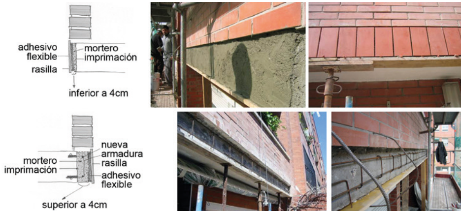
Fig. 41.5. En los tres gráficos superiores, las losetas se recolocan una vez reparadas las armaduras oxidadas del forjado y restituido el hormigón de recubrimiento. En los tres gráficos inferiores, las losetas se recolocan igualmente con el mortero adecuado, con la rectificación previa de la alineación del canto del forjado con hormigón y la colocación de armado suplementario.
