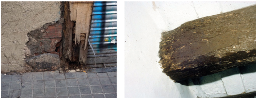
Fig. 13.2. Ejemplos de pudrición de elementos de madera, visibles en la zona próxima a su empotramiento.
