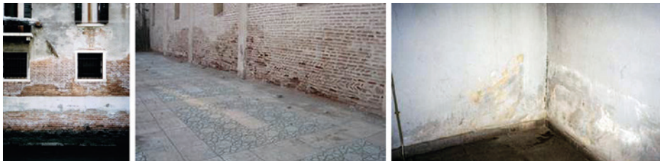
Fig. 33.1. Visión de las manchas de humedad por el exterior de una fachada de ladrillo y por el interior de una esquina de un muro enyesado.
