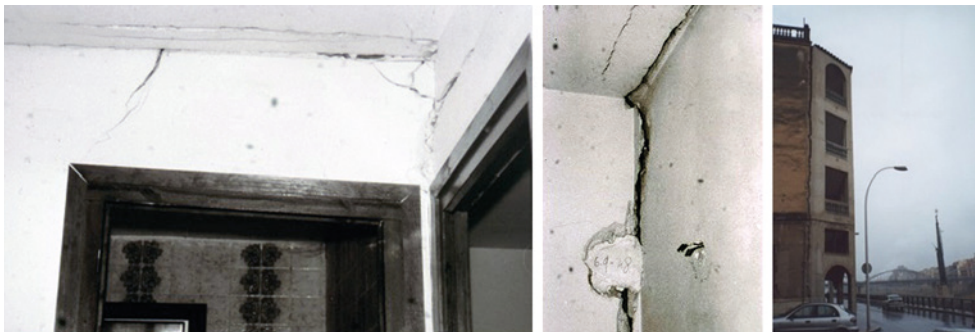
Fig. 28.5. A la izquierda y en el centro, ejemplos de descuadre de puerta y descenso del pavimento de planta baja a causa del movimiento del terreno. A la derecha, un caso de continuación de la grieta por pared y techo.
