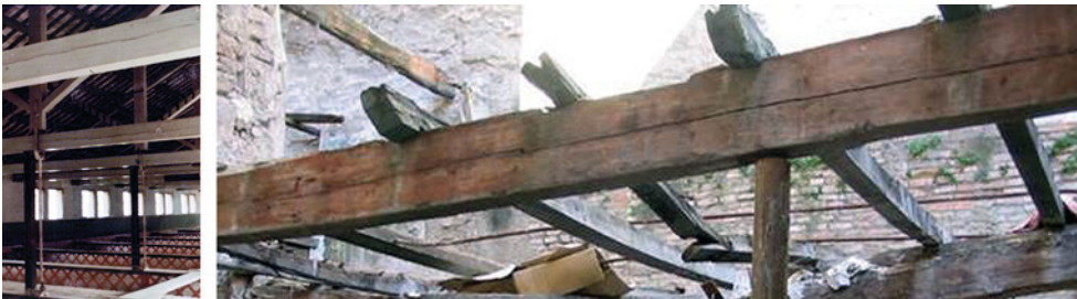
Fig. 18.3 Cercha y biga de madera con presencia de fendas longitudinales originadas en el periodo de secaje.
