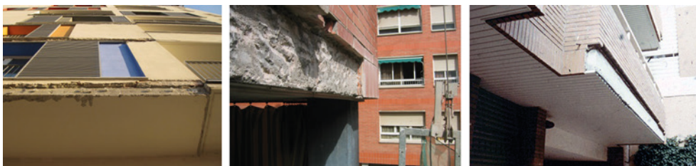
Fig. 41.2. Ejemplos de grosores excesivos por delante del canto del forjado. La foto de la derecha muestra la corrección con el ladrillo del error de replanteo del canto del forjado en dirección horizontal.
