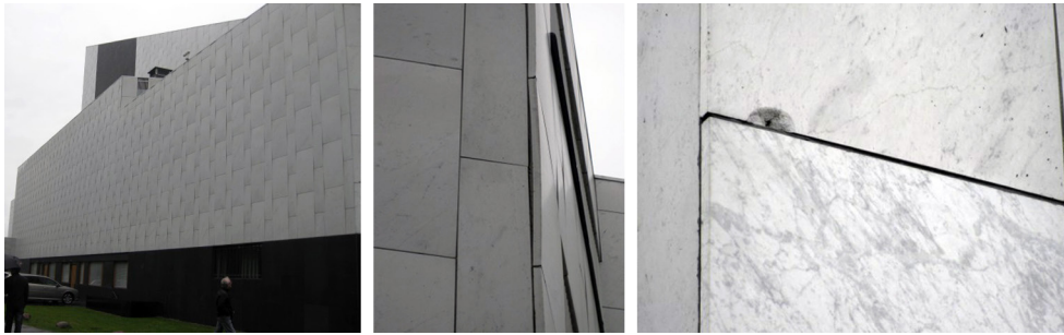
Fig. 40.7. Edificio Finlandia Hall en Helsinki, de Alvar Aalto. Estado del recubrimiento con piezas de mármol de Carrara. Son visibles el alabeo generalizado de las piezas y alguno de sus efectos derivados (2019).
