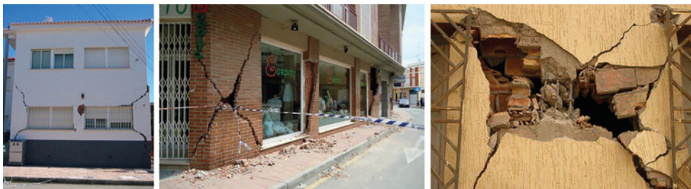
Fig. 31.1. Ejemplos de cuadros fisurativos típicos en muros de edificios afectados por movimientos sísmicos.
