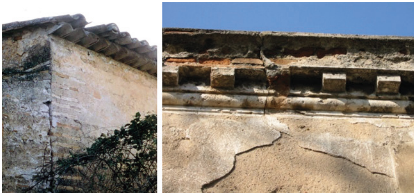
Fig. 43.3. Ejemplos de desprendimiento de materiales de los aleros en edificios de construcción tradicional.
