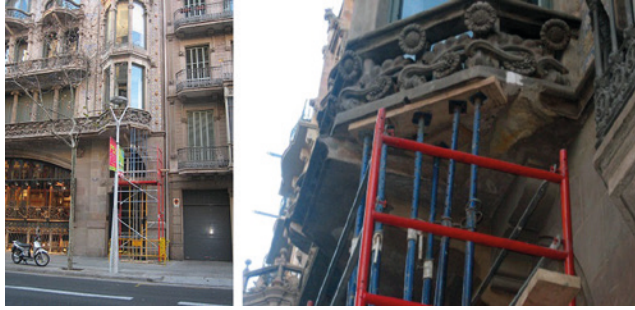
Fig. 27.2. Desprendimiento de una porción de losa de piedra de la parte inferior de una tribuna, después de adoptar medidas preventivas.
