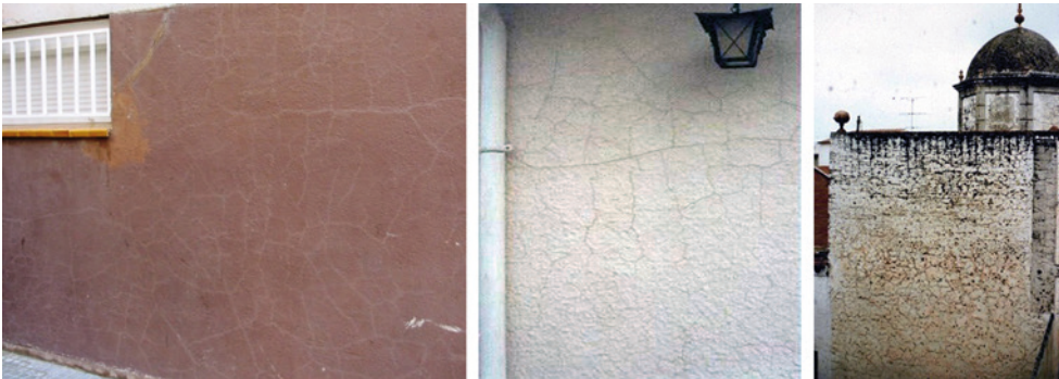
Fig. 38.1. En la foto de la izquierda y central, revestimiento monocapa de cemento portland afectado por afogado. En la foto de la derecha, revestimiento de cal con el mismo daño.
