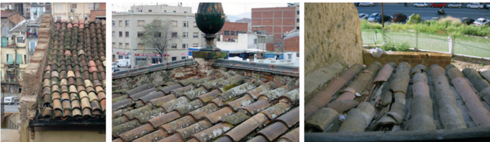
Fig. 53.3. Resolución incorrecta de los encuentros perimetrales de las tejas y presencia de tejas rotas.
