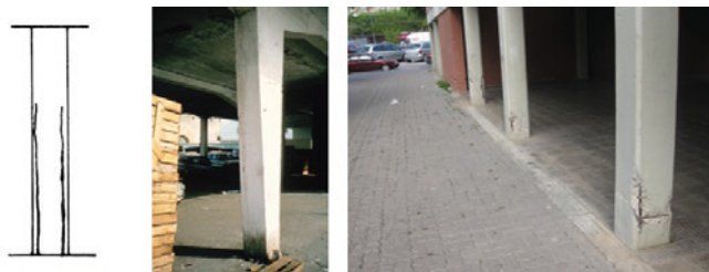
Fig. 9.2. En el gráfico y la foto central, localización de las fisuras en los pilares, coincidentes con la localización de las armaduras principales. En la foto derecha, pilares con los síntomas habituales de la oxidación de las armaduras en sus bases, con desprendimiento del material que las recubre.
