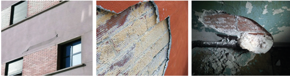
Fig. 37.2. Ejemplos de procesos de desadherencia que muestran, en la foto de la izquierda, la fase de abombamiento anterior a su desprendimiento zonal, en la foto central, los síntomas de desadherencia en el contorno del revoco ya desprendida, y en la foto de la derecha, la presencia de un depósito de sal detrás del revestimiento.
