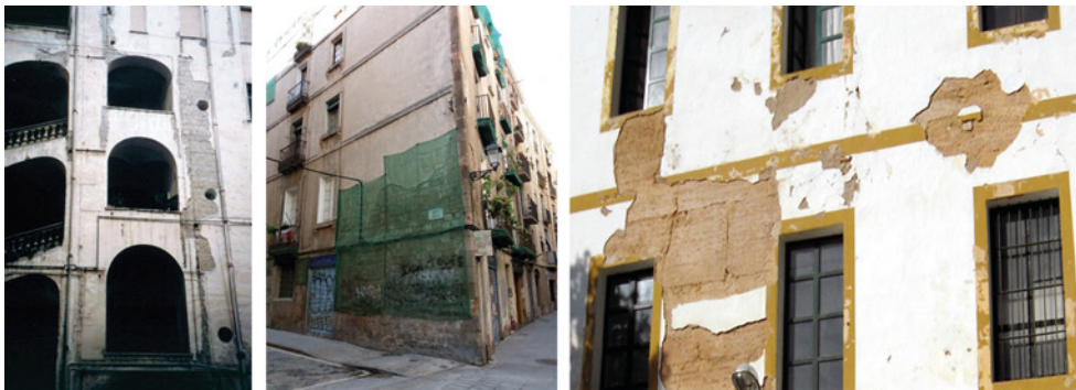
Fig. 37.1. Ejemplos de desprendimiento zonal del revestimiento en muros de materiales diversos.
