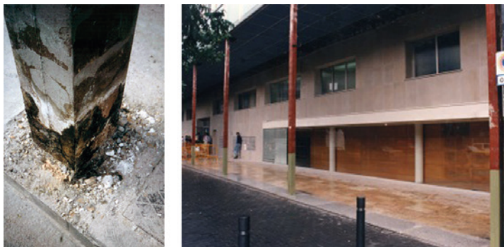
Fig. 10.1. En la foto de la izquierda, base de un pilar exterior de un porche con fuertes síntomas de corrosión. En la foto de la derecha, pilares del porche de la figura anterior una vez reparados con suplemento de chapa de acero y pintura protectora.
