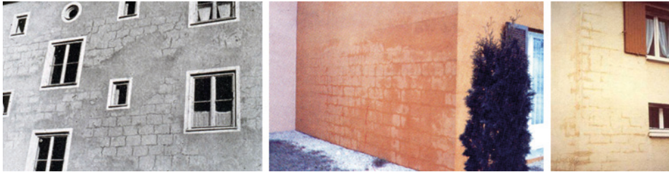
Fig. 38.2. Ejemplos de fisuración por retracción hidráulica en fachadas a base de bloques de hormigón revestida con mortero de cemento portland. En los tres casos, las fisuras se marcan en las juntas de las fábricas aún humedecidas después de la lluvia.
