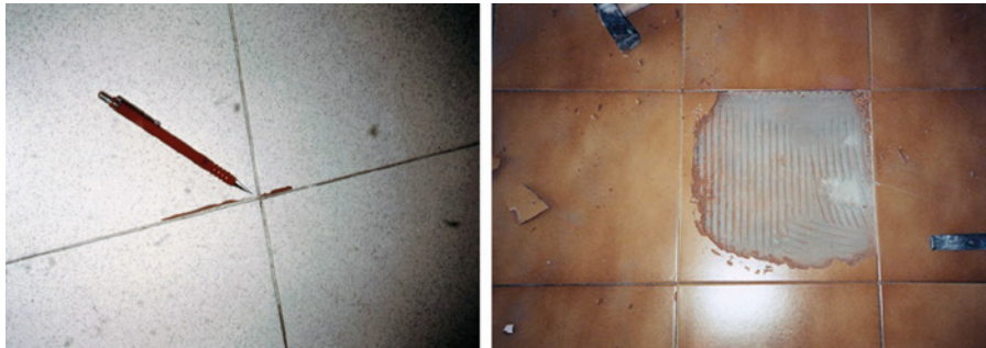
Fig. 58.1 En la foto de la izquierda, descantillado de una de las juntas en un pavimento colocado prácticamente con junta a tope. En la foto de la derecha, marcas en el mortero cola que muestran la insuficiente presión en el momento de la colocación.
