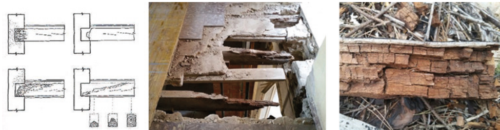
Fig. 13.1. Esquema del avance de la pudrición en el apoyo de una viga. En las fotografías, ejemplos de vigas afectadas por pudrición parda.
