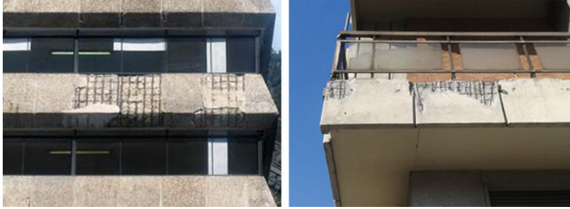
Fig. 43.2. Ejemplos de corrosión de las armaduras en barandillas formadas con paneles de hormigón armado.
