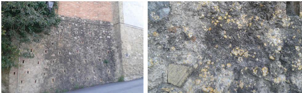
Fig. 51.2. En la foto de la izquierda, crecimiento de líquenes, hongos y musgo sobre una pared de mampostería. En la foto de la derecha, crecimientos de líquenes (manchas ocre) y hongos (manchas oscuras).
