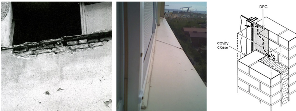
Fig. 48.3. En la foto de la izquierda, daños en el revoco propiciados por el estado del vierteaguas. En la foto central, vierteaguas de chapa con junta intermedia, lugar frecuente de las infiltraciones de agua de lluvia. En el gráfico de la derecha, recorrido del agua infiltrada por la junta entre carpintería metálica y obra de ladrillo.
