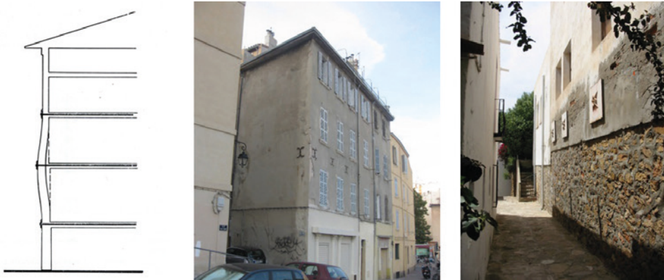
Fig. 2.4. Ejemplos de atirantamiento de muros exteriores de fachada. Obsérvese las placas de anclaje situadas en la zona más saliente del muro.
