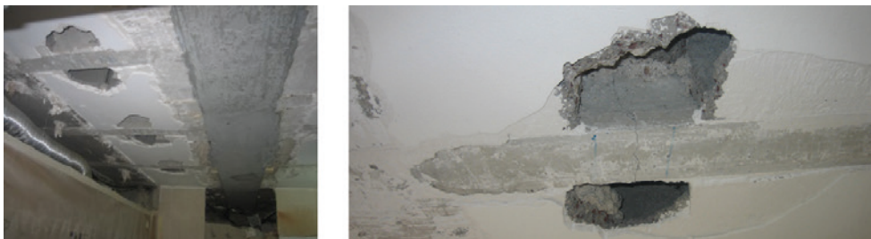
Fig. 15.1. Viguetas pretensadas con grietas próximas a la jácena plana. Abertura de calas para su detección en la sección de las piezas.
