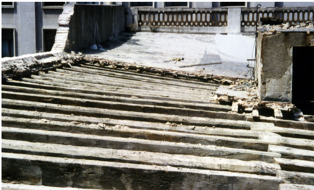
Figura 68 Coberta mal anomenada "plana", que resol els terrats fins a la primera dècada del segle XX. Els seus pendents generosos faciliten el desguàs cap als patis interiors
