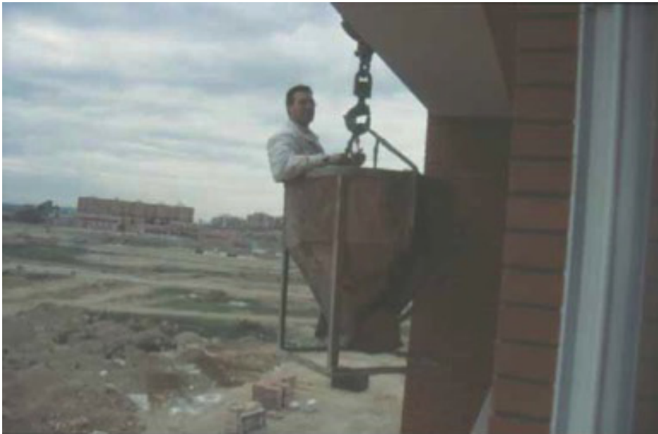
Fig.2.15. Ejemplo riesgo por mala planificación en el desmontaje de andamio tubular sin repaso fachadas.
