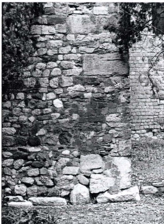
Fig. 1.7. Esquina de Santa María de Tarrasa. No hay justificación para el desorden del apoyo del muro
