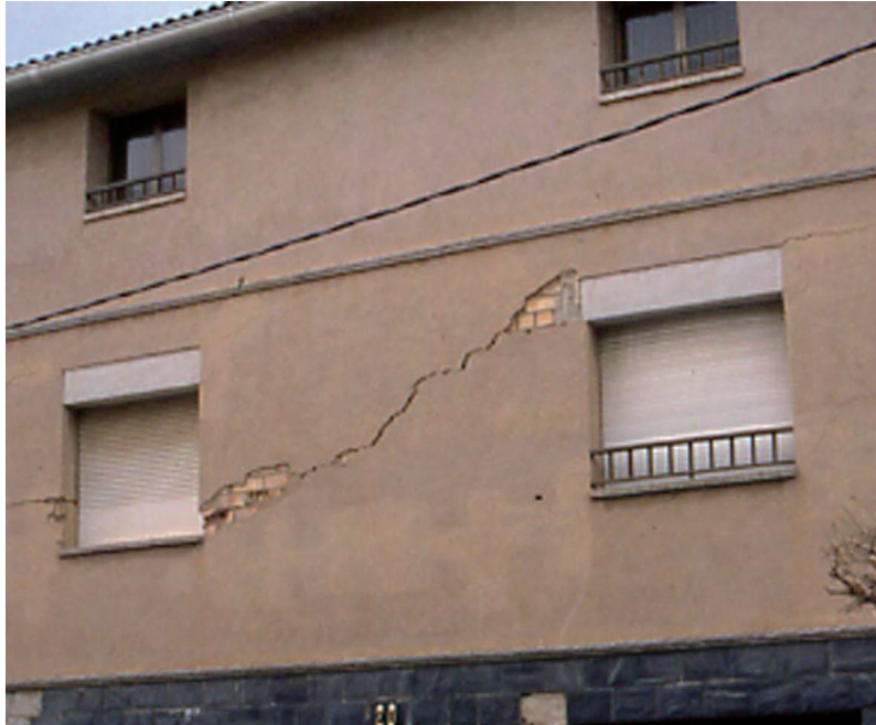
Fig. 156 Edificio afectado por la subsidencia del subsuelo.
