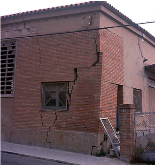
Fig. 155 Parte del edificio se apoya sobre un relleno.
