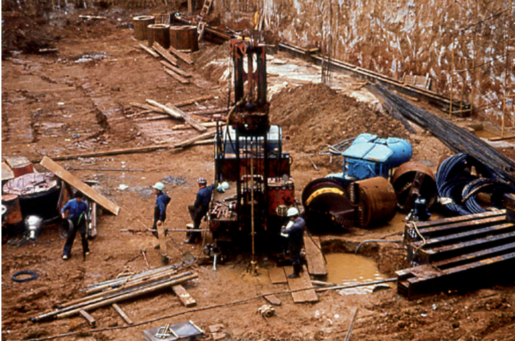
Fig. 193 Ampliación del estudio geotécnico por la aparición inesperada del nivel freático.
