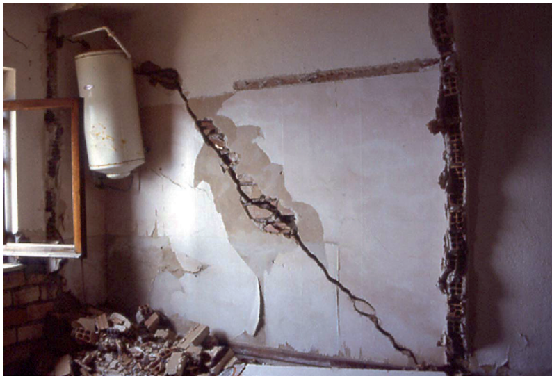
Fig. 157 La inestabilidad del suelo es incompatible con la construcción.
